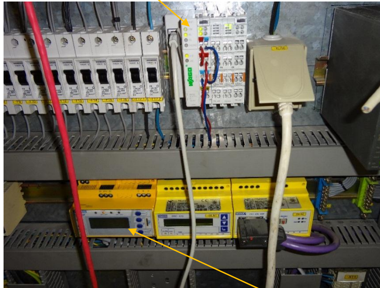
Εικόνα 1: plc και κεντρική δικτυακή μονάδα
