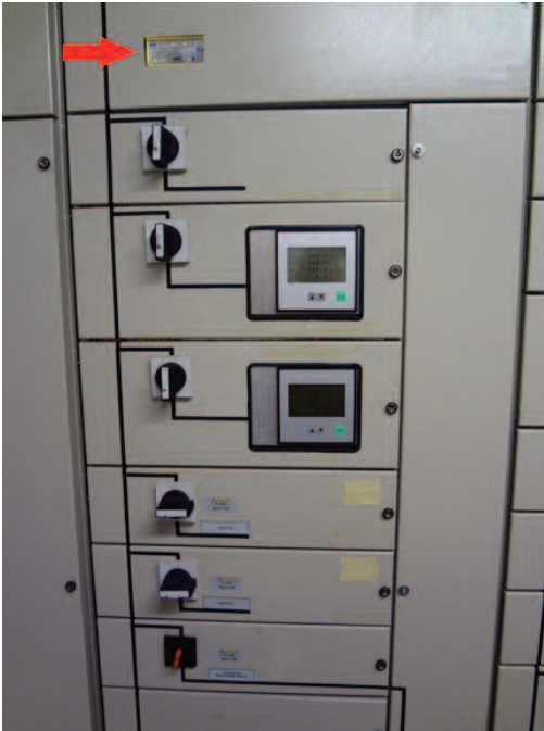
Μονάδα επιτήρησης Bender σε γειωμένο δίκτυο (κόκκινο βέλος)
