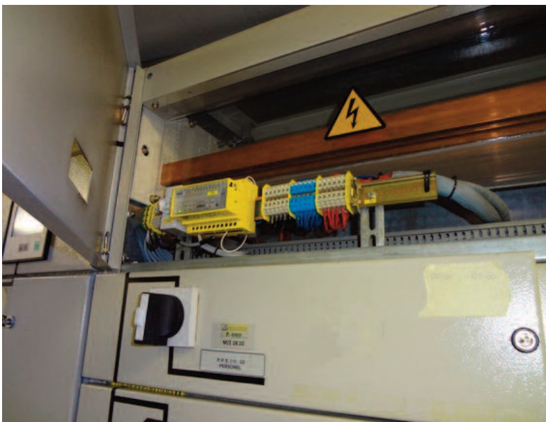
Συνδεσμολογία των παραπάνω Μ/Σ με τη μονάδα της Bender όπου γίνεται η επιτήρηση των διαρροών.
